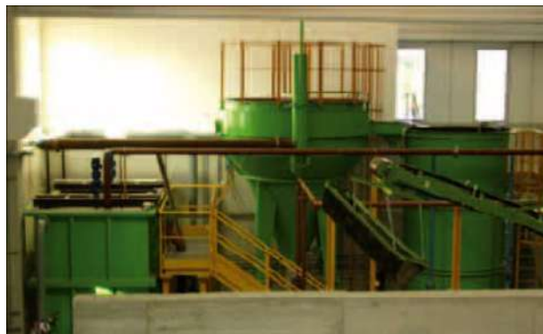
Depuratore Chimico fisico, sedimentatore e stoccaggio
