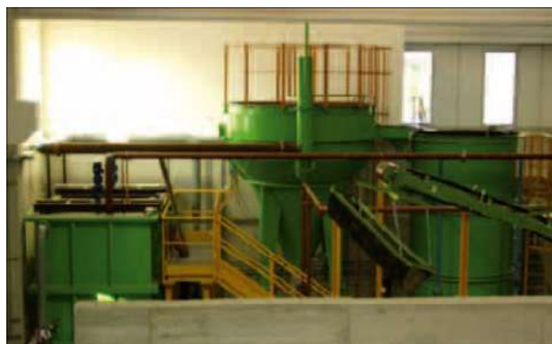
Depuratore Chimico fisico, sedimentatore e stoccaggio
